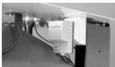
Styrboxpanel med diodlampan
